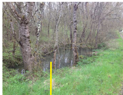
Avant : Mare d'eau visible en contrebas due à une fuite.
